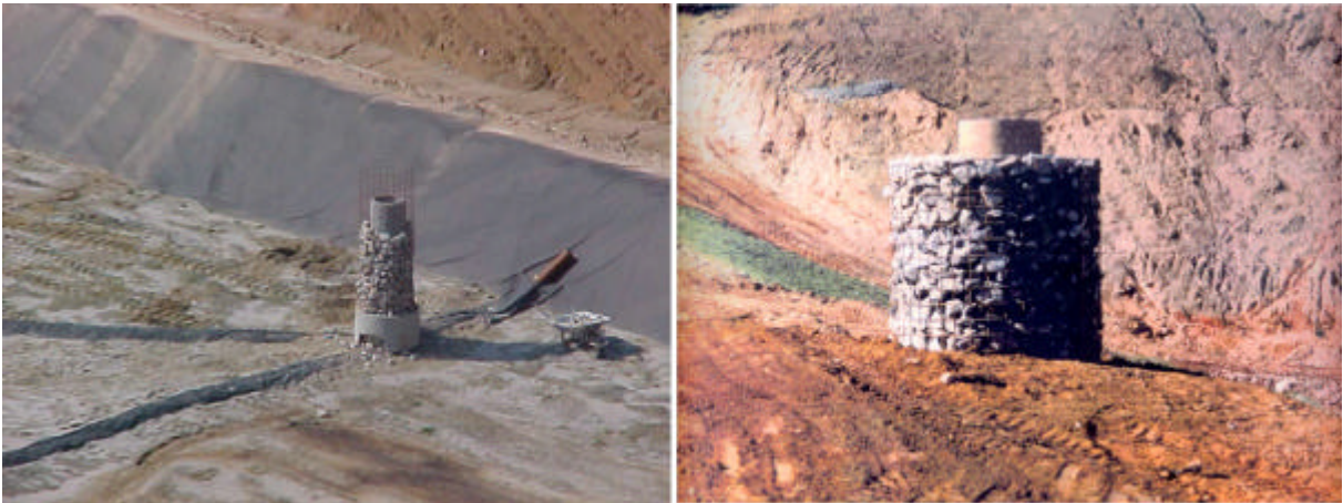
Figura 2.5 – Drenos de biogás na base do aterro sanitário e dreno no aterro em operação
