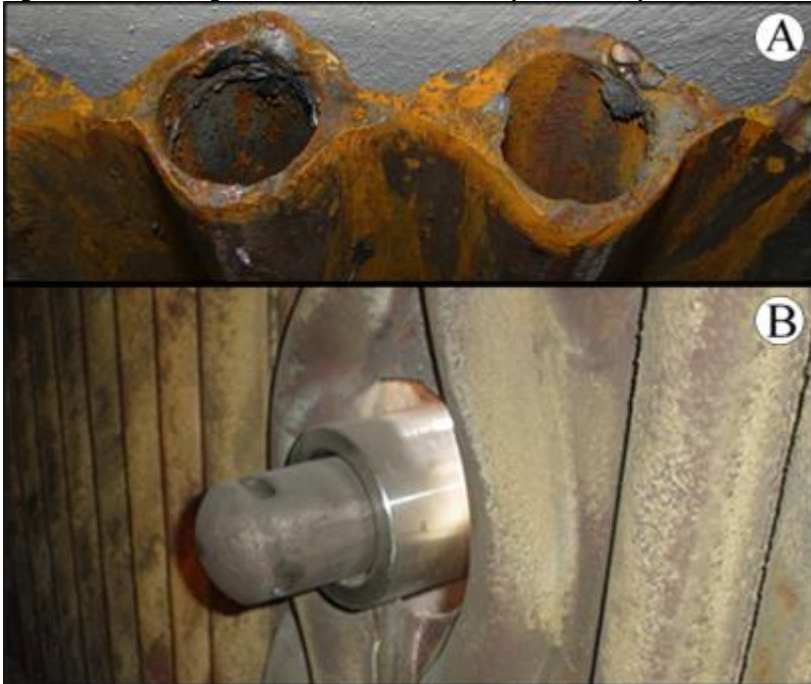
Figura 1 - Tubos desgastados em A e o local do soprador de vapor em B.
