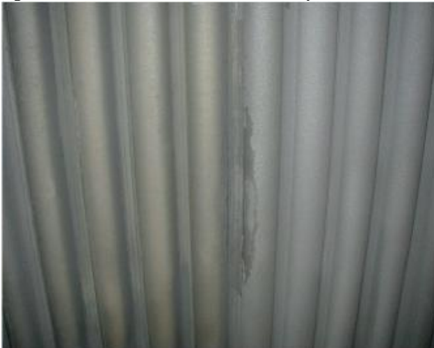
Figura 10 - Defeito no revestimento com aspersão térmica
