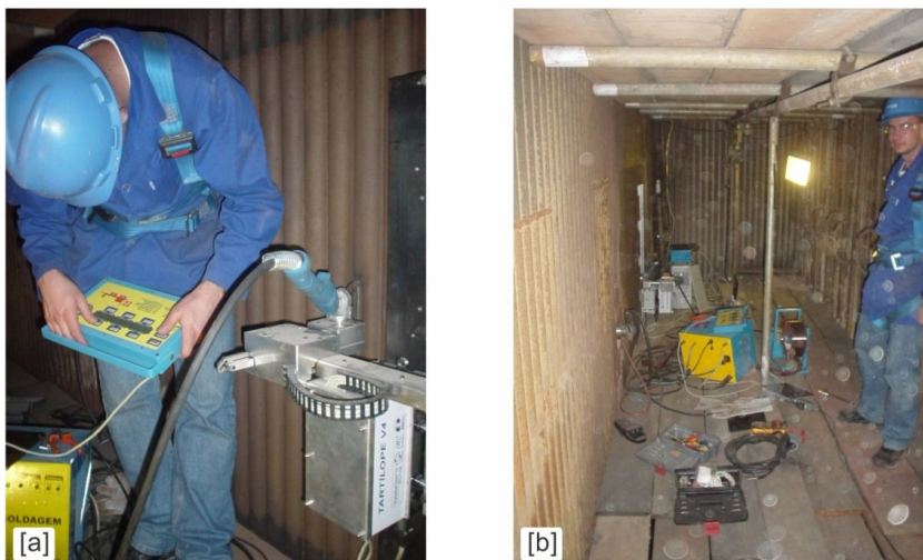
Figura 13 - Equipamento de soldagem automatizada instalado no interior de uma caldeira de termelétrica, [a] operador configurando o equipamento, [b] ambiente de trabalho
