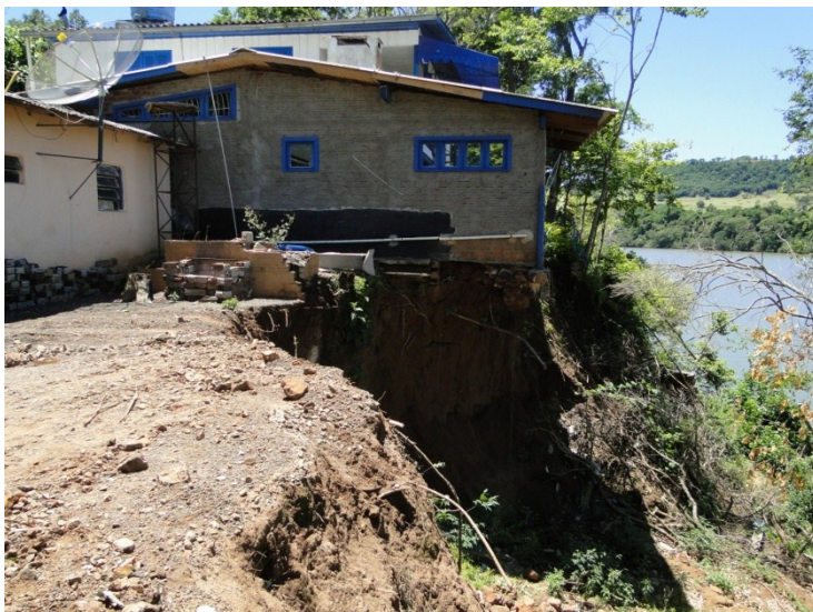
Figura 59: Edificação em APP, com risco de desmoronamento em virtude da enchente ocorrida em 2010. Fonte: arquivo pessoal.
