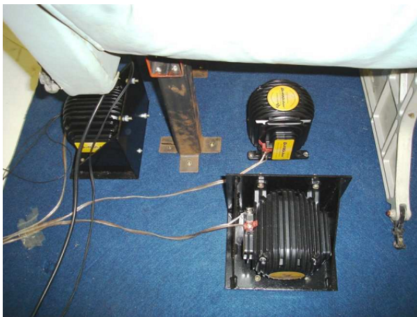
Figura 10: Disposição dos excitadores de vibração instalados.
