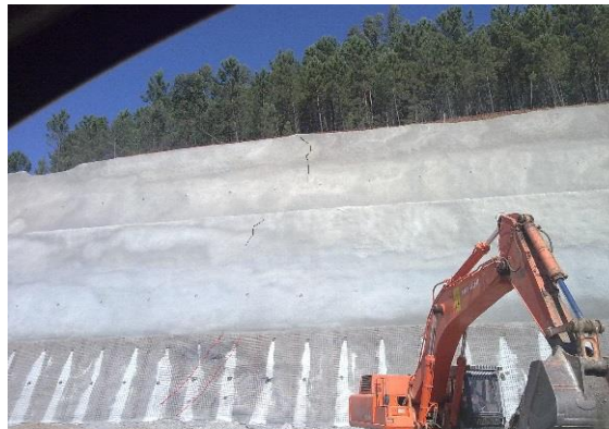
Marcação da falha para o adjudicatário
