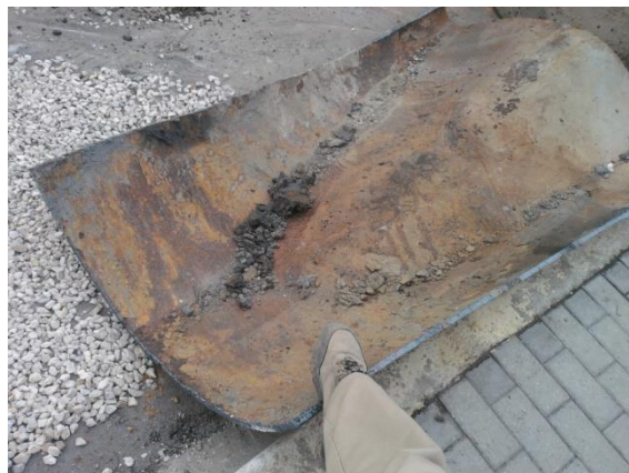
Aspeto da face do tubo removido devido à colisão com blocos
