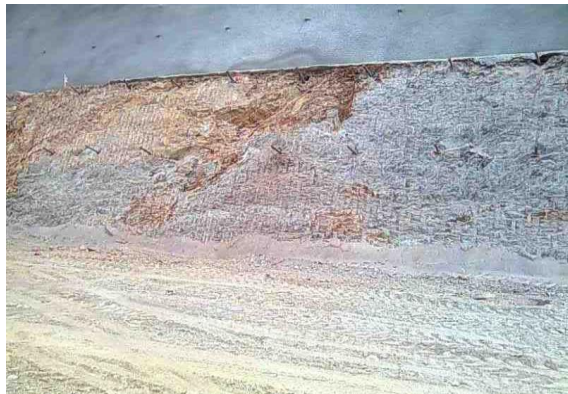
Aspetto da falha no talude
