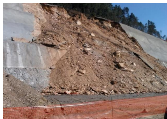
Aspetto após a rotura global
