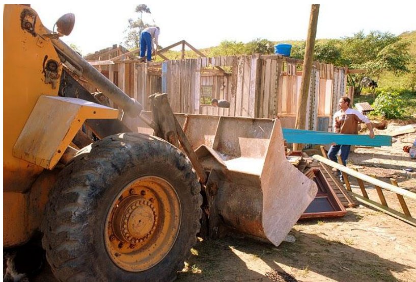
Figura 44: Um trator desconstruindo a residência de uma família de agricultores dos Areais da Ribanceira de Imbitiuba/SC. Foto: Pepe Pereira dos Santos, agosto/2010.
