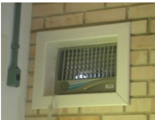
Figura 2.13 – Insuflador de ar posicionado no quarto de casal.
