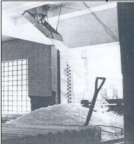
Foto7: Rio Grande/RS: Instalações da fábrica Joqueira - Saída do gelo em escamas diretamente do silo para o caminhão
