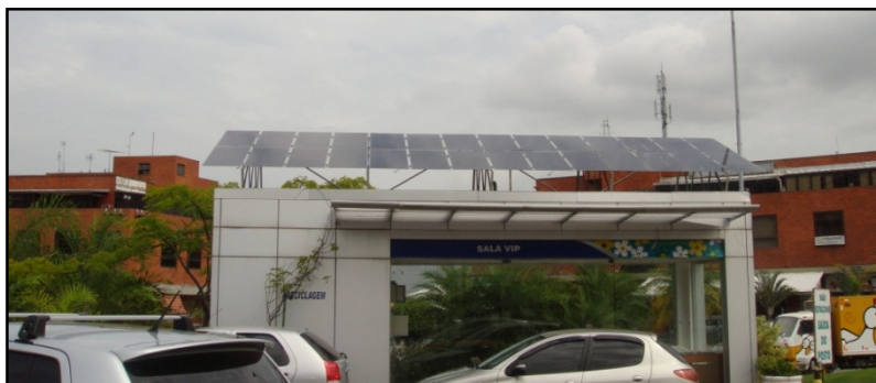
Figura 60: Vista do posto BR no Rio de Janeiro com o painel FV de 1,12 kWp em sua cobertura.
