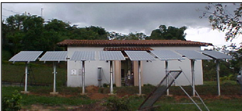
Figura 26: Vista geral do SFCR de 3,15 kWp do Laboratório de Sementes da CEMIG.
