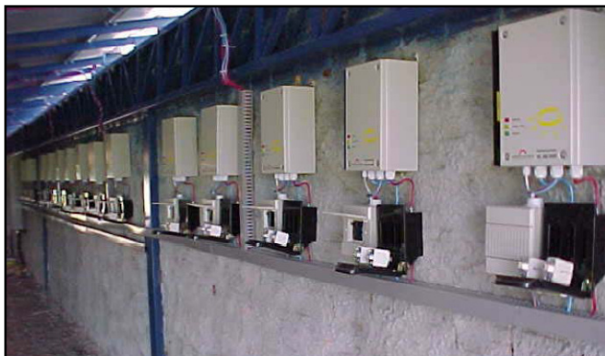
Figura 68: Vista dos inversores WÜRTH utilizados no sistema híbrido FV-diesel da vila de Araras, em Rondônia.
