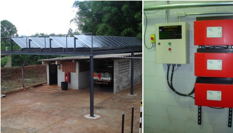
Figura 31: Vista geral dos painéis FV e dos inversores do SFCR de 7,5 kWp da UNICAMP.
