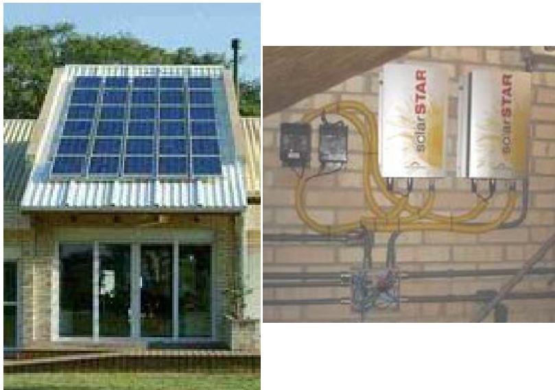
Figura 30: Vista geral dos módulos e dos inversores do SFVR de 2,25 kWp da Casa Eficiente / ELETROSUL.
