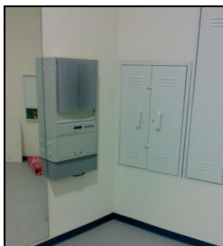
Figura 39: Inversor XANTREX utilizado no SFCR de 2,87 kWp de uma residência em São Paulo - SP.
