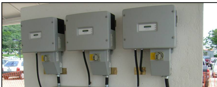
Figura 51: Vista dos inversores SB4000US do SFCR de 11,97 kWp da ELETROSUL.
