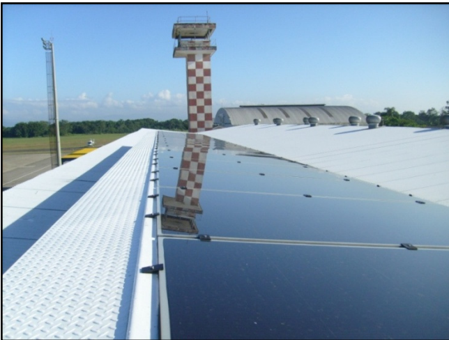
Figura 58: Vista geral do SFCR de 2,12 kWp do Aeroporto Hercílio Luz, em Florianópolis.
