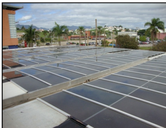
Figura 63: Vista do painéis FV de 6,4 kWp do Condomínio Pedra Branca em Palhoça - SC.
