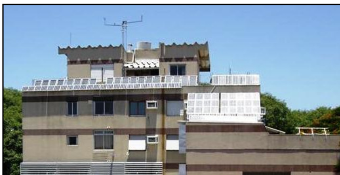
Figura 13: Vista geral do prédio da IEM no qual o SFCR de 3 kWp foi instalado.
