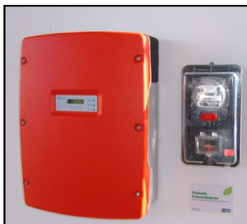
Figura 64: Vista do inversor SMC6000A e do medidor de energia do SFCR de 6,4 kWp do Condomínio Pedra Branca, em Palhoça - SC.
