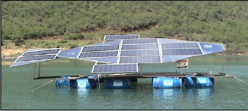
Figura 34: Vista geral do sistema FV de 1,5 kWp do Restaurante Lampião, em Piranhas - AL.
