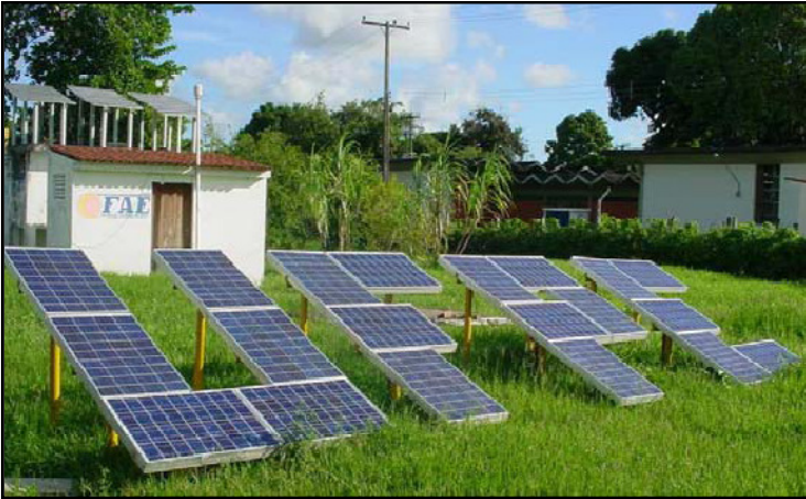
Figura 28: Vista geral do SFCR de 1,28 kWp da UFPE.
