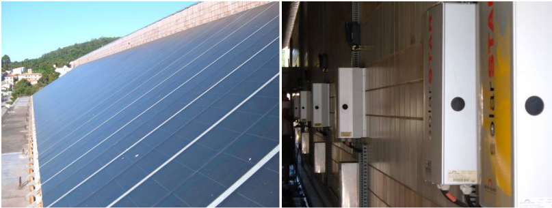
Figura 21: Vistas dos módulos FV e dos inversores utilizados no SFCR do Centro de Cultura e Eventos da UFSC.
