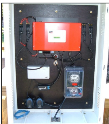
Figura 57: Vista da parte interna da caixa de conexões do SFCR de 1,99 kWp do Hospital Universitário na UFSC, com o inversor SB2500 na parte superior.
