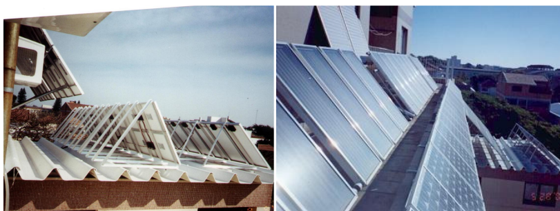
Figura 14: Vista dos módulos do SFCR de 3 kWp da IEM.
