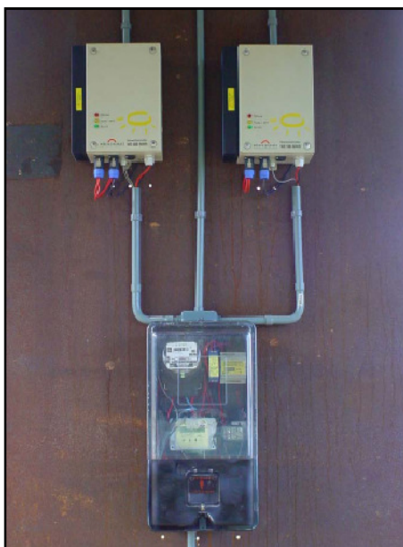
Figura 17: Vista dos inversores WÜRTH utilizados no SFCR de 1,41 kWp da CELESC em Florianópolis.
