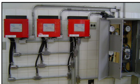
Figura 27: Vista dos inversores SB1100 do SFCR de 3,15 kWp do Laboratório de Sementes da CEMIG.
