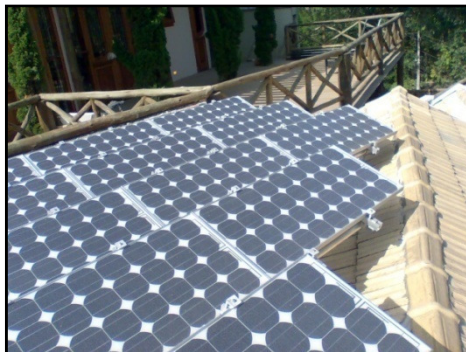
Figura 38: Parte dos módulos FV do SFCR de 2,87 kWp de uma residência em São Paulo - SP.
