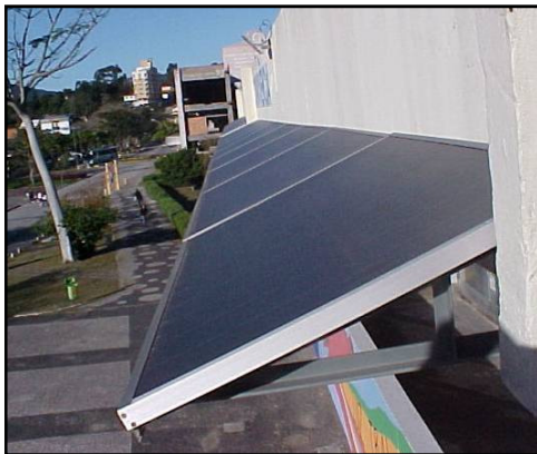
Figura 8: Vista dos módulos UNISOLAR US-64 do SFCR de 1,15 kWp do Centro de Convivência da UFSC.
