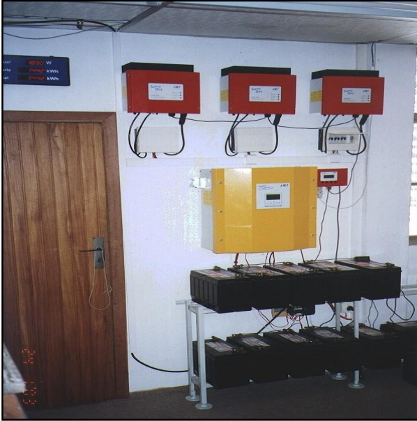
Figura 15: Vista dos inversores do SFCR de 3 kWp da IEM.
