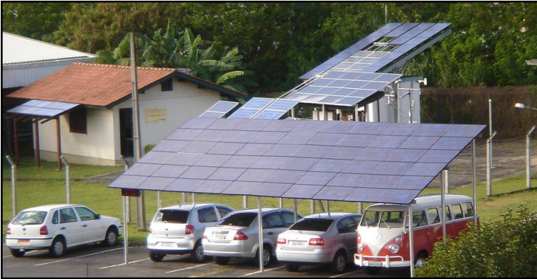
Figura 24: Vista geral do SFCR de 3 kWp do LSF-IEE / USP.
