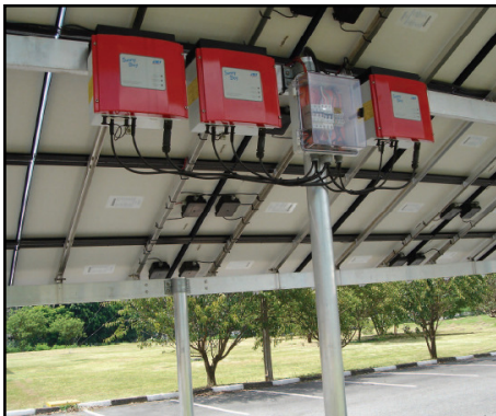
Figura 25: Vista dos inversores SB1100U utilizados no SFCR de 3 kWp do LSF – IEE / USP.
