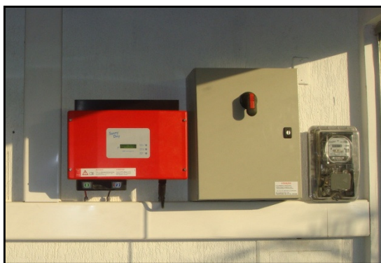
Figura 61: Inversor SB1100, caixa de conexões e medidor de energia utilizados no SFCR de 1,12 kWp no posto BR do Rio de Janeiro - RJ.
