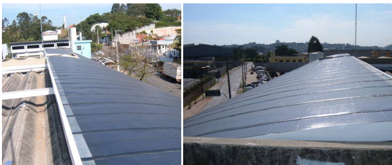
Figura 46: Vistas do painel FV do sistema de 14,69 kWp da Fundação Estrela.
