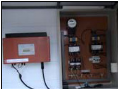
Figura 29: Vista do inversor de 1,1 kW do SFCR de 1,28 kWp da UFPE.
