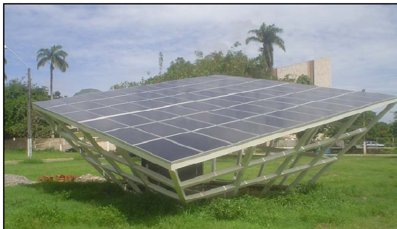
Figura 65: – Vista do SFCR FV de 3,3 kWp da UFPE, em Recife - PE.
