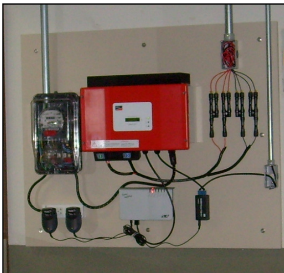
Figura 59: Vista do inversor SB2500 do SFCR de 2,12 kWp do Aeroporto Hercílio Luz, em Florianópolis.
