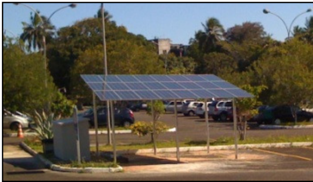
Figura 62: Paineis FV do SFCR de 3,12 kWp da COELBA, em Salvador - BA.
