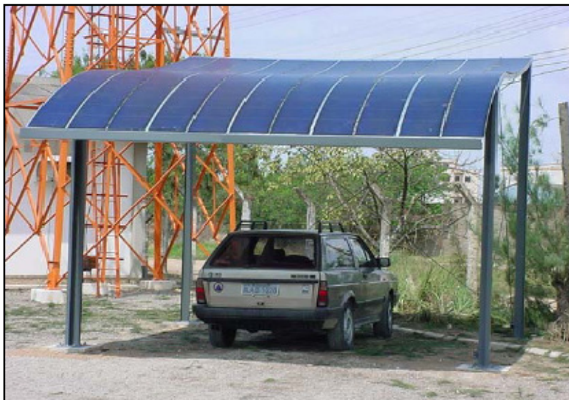
Figura 19: Vista geral do sistema FV de 1,41 kWp da CELESC, em Tubarão.
