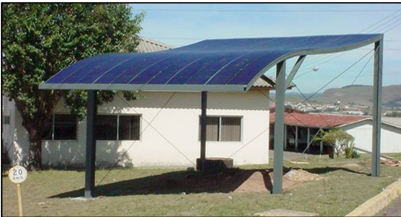
Figura 18: Vista geral do sistema FV de 1,41 kWp da CELESC, em Lages.
