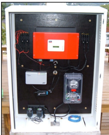
Figura 54: Vista da parte interna da caixa de conexões do SFCR de 1,99 kWp do Colégio de Aplicação da UFSC, com o inversor SB2500 na parte superior.
