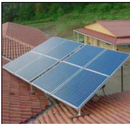
Figura 69: Painel FV de 2,4 kWp instalado em Fernando de Noronha - PE. Fonte: (BARBOSA et al. , 2004 apud BENEDITO, 2009)
