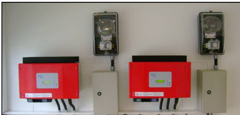
Figura 43: Vista dos inversores SB1100 do SFCR de 2,45 kWp da Motor Z.
