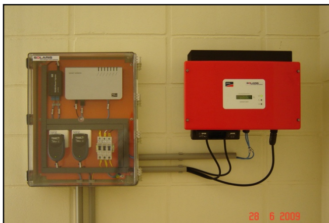
Figura 41: Inversor e WebBox do SFCR de 1,04 kWp da empresa SOLARIS, em Leme - SP.
