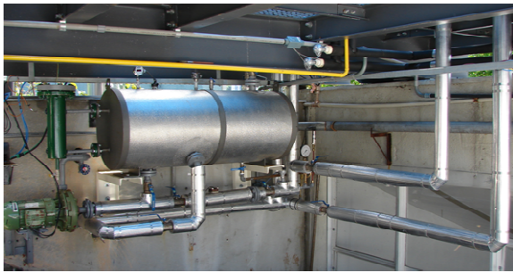
Figura 4.6 - Tubulação vapor e de água quente do subsistema de recuperação de calor.
