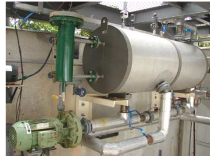
Figura 4.7 - Tambor separador e bomba de recirculação da caldeira de recuperação.
