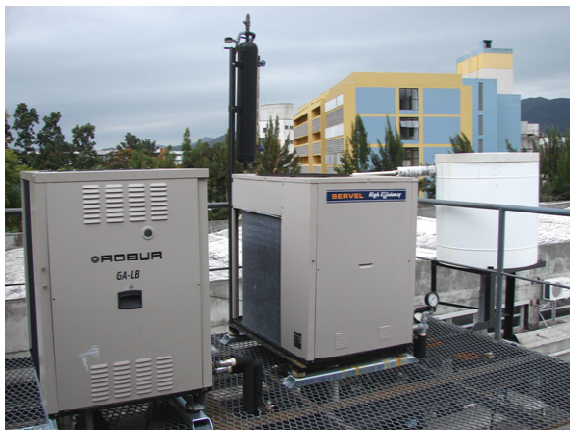
Figura 4.10 – Vista parcial da plataforma, mostrando a máquina frigorífica, máquina de climatização e termoacumulador.
