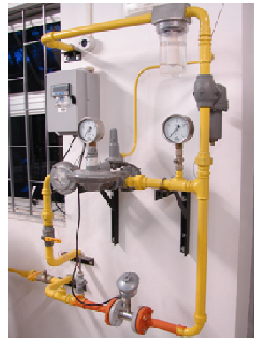
Figura 4.3- Estação de controle, segurança e medição de GNC
