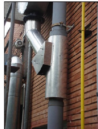
Figura 4.9 - Direcionador de fluxo dos gases de exaustão
