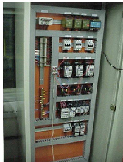
Figura 4.5 - Painel de chaveamento.
