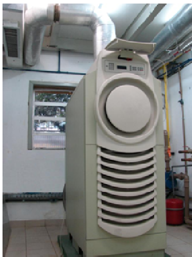
Figura 4.4 – Microturbina a gás natural.
