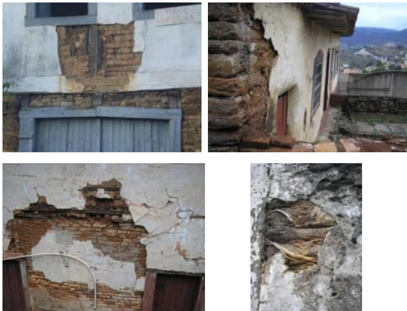
Figura 18: Descolamento de reboco em paredes diversas
