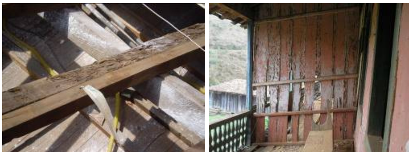
Figura 11: Exemplos de degradação da madeira pela exposição às intempéries e má conservação
