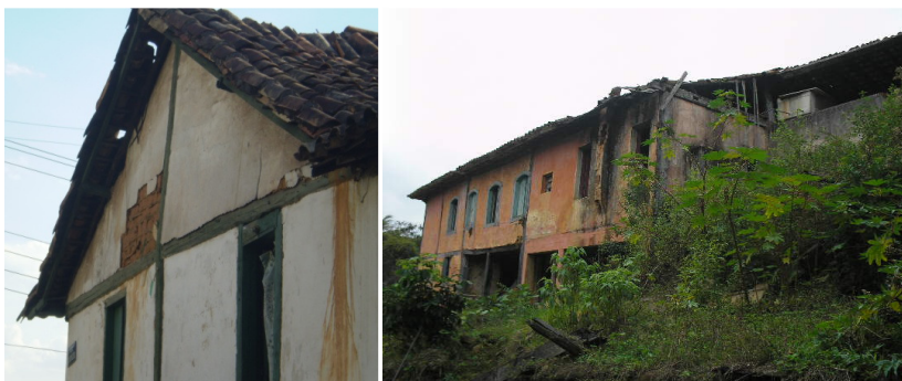
Figura 10: Coberturas mal conservadas
