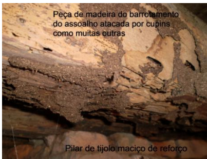
Foto 12: Uma das vigas do assoalho degradada
