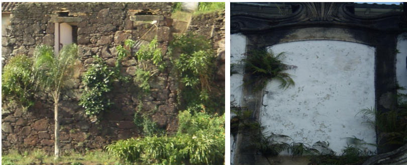
Figura 13: Infestação de vegetação em obras de pedra.
