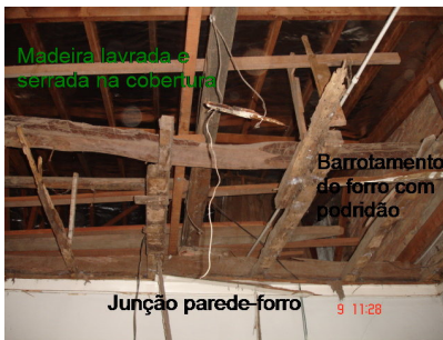
Foto 16: Junção Alvenaria – forro (retirado)
