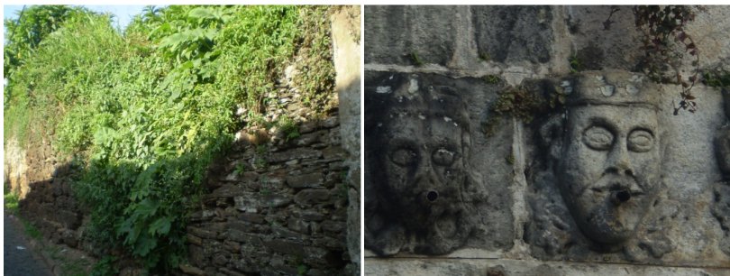
Figura 14: Presença de vegetação em obras de pedra
