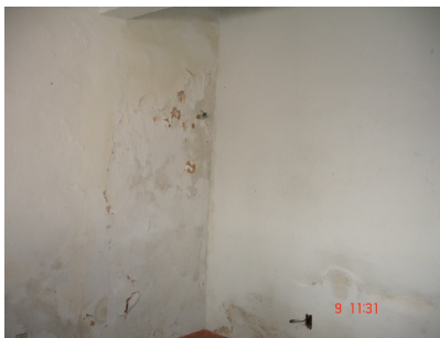
Foto 18: Danos do revestimento por umidade
