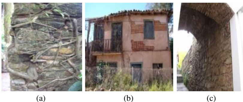
Figura 16: (a) Raízes penetrando entre as pedras; (b) Vegetação por toda a fachada, demonstrando total abandono; (c) Vegetação no muro.
