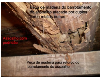
Foto 13: Outra viga do assoalho degradada
