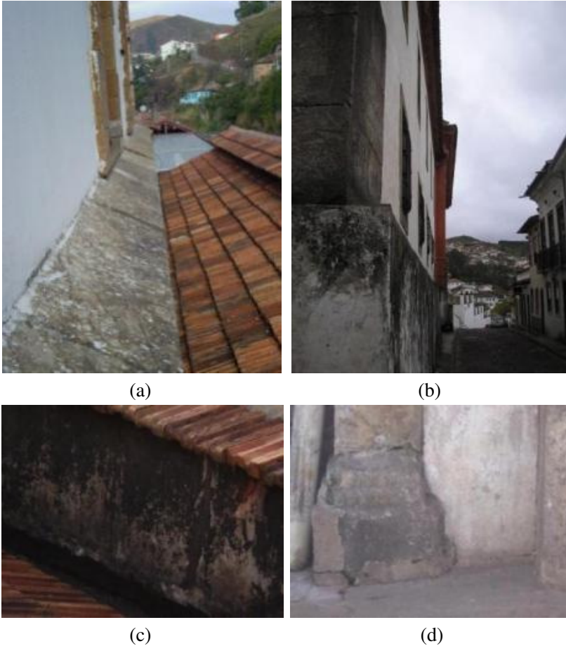
Figura 17: (a) Evidência de intervenção feita sem o devido cuidado; (b) e (c) Presença de bolor; (d) Evidências de estrutura de pedra danificada devido a intervenção inadequada
