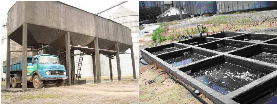
(a) Silo de armazenagem e filtração da água
