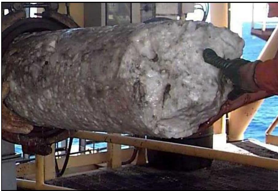
Figura 10 – Formação de plug de HG em tubulação da Petrobras usada na produção de hidrocarbonetos (Centre for Gas Hydrate Research – Heriot Watt University, 2005).
