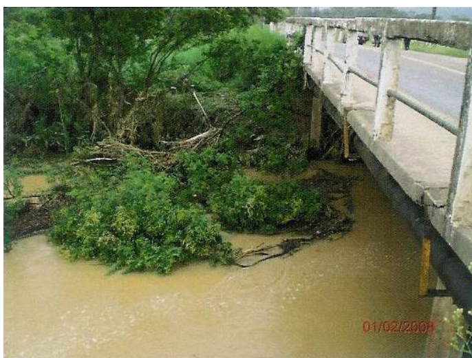
Figura 6.3: Ponte baixa sobre o rio Forquilhas destacando a vegetação trazida pelas águas, prejudicando o escoamento.
