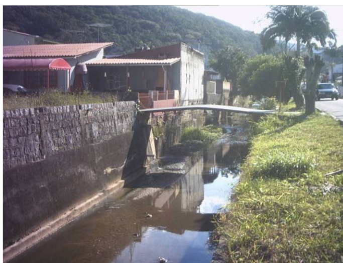
Figura 6.12: Nota-se uma pequena ponte sobre o canal para poder dar acesso à garagem da casa.
