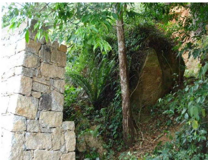
Figura 6.21: Presença de um dos blocos de rocha que se encontram nessa encosta, notar que esse bloco se encontra bem perto do muro que ainda está em construção.
