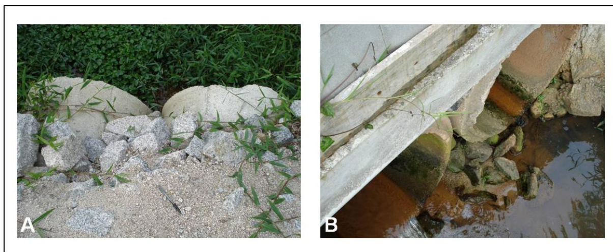
Figura 6.7: A) Detalhe da tubulação que foi colocada sob a ponte para escoar as águas que passam pelos canais no Loteamento Ceniro. B) Maior detalhe da tubulação. Autor: Francielle Cardozo, dia 06/02/09.
