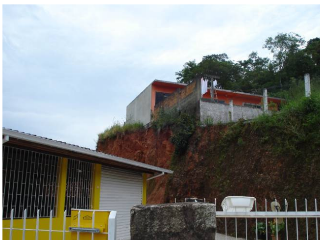
Figura 6.31: Duas casas inseridas em um local perigoso devido ao corte com inclinação de 90° na encosta.
