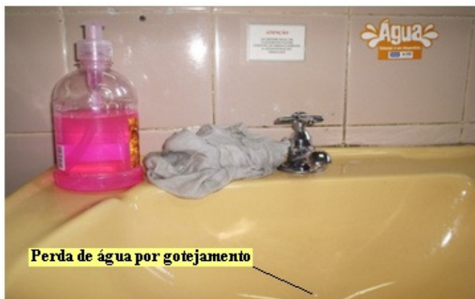
Figura 20 - Desperdício de água por gotejamento em lavatório.
