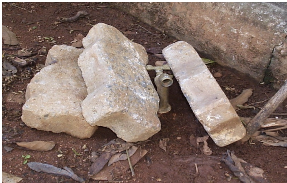
Figura 8 - Torneira externa em canteiro de jardim da escola.
