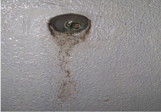
Figura 6 - Válvula de descarga em instalação sanitária do primeiro pavimento.
