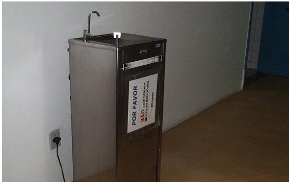
Figura 11- Bebedouro do primeiro pavimento com cartaz de economia de água e higiene.
