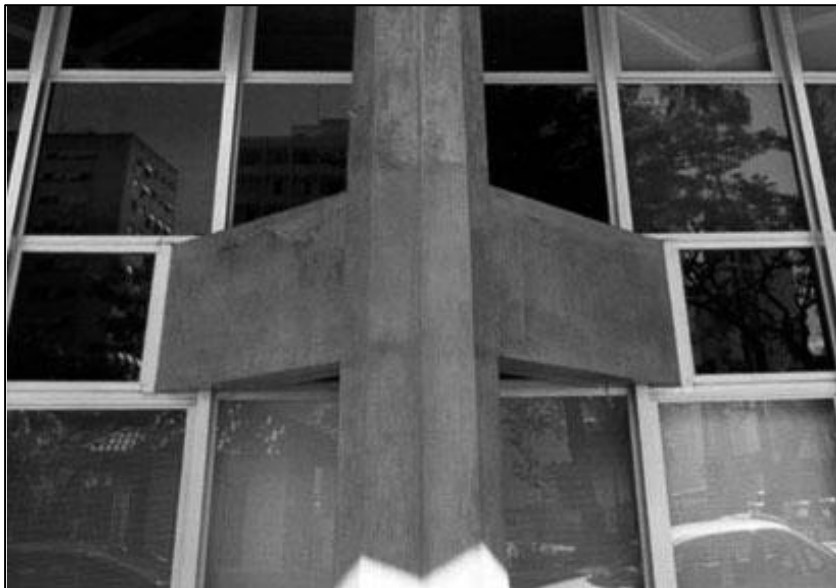
Figura 143 - Agência do Banco Safra – Detalhe estrutura e aberturas. Projeto: Liz e Monteiro [1973] - 2003
