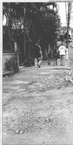
Plano Diretor define melhorias nos passeios, como na Rua Benjamin Constant, no Barro Escola Agrícola
