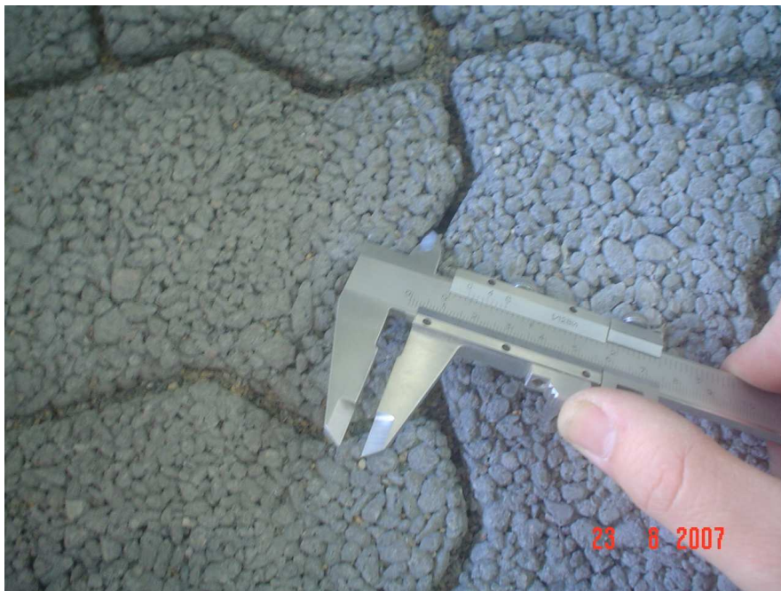
Figura 3.49 – Medição da largura das juntas entre os blocos.
