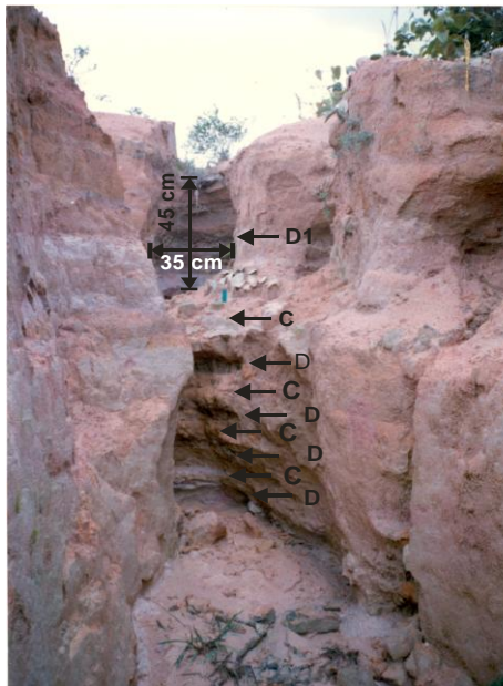
FIGURA 24 – Costelas separadas por depressões. A presença dessas duas feições confirma as diferenças entre o material mais resistente (costelas = C) e o menos resistente (depressões = D). A depressão D1 configura-se como uma pequena alcova. Voçoroca Petrobrás. Distrito Industrial. Zona Sul. Manaus-AM. (1997)
