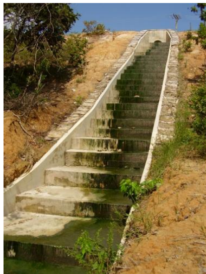
FIGURA 91 – Vista parcial e frontal da escadaria de concreto (28/07/2007). Percebe-se que as bordas da estrutura estão protegidas com sacos de solo-cimento, evitando assim a formação de sulcos, diferente do que ocorreu na canaleta que deu origem à voçoroca nº 84 (ver FIGURA 73 , p. 178). Distrito Industrial. Manaus-AM. (2007).
