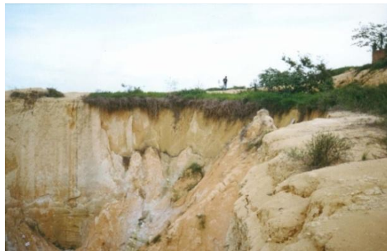
FIGURA 86 - Voçoroca originada pelo desvio das tubulações (águas servidas e pluviais) da cabeceira da voçoroca da Creche. Conjunto Canaranas - Cidade Nova. Manaus-AM. Agosto/1997. Fonte: Vieira (1998)
