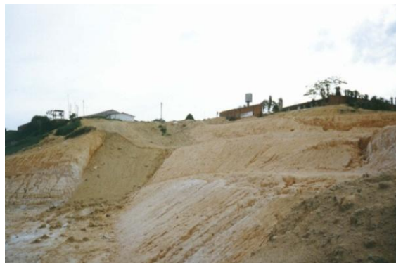
FIGURA 87 - Patamares mal compactados na obra de contenção, voçoroca da Creche. Conjunto Canaranas - Cidade Nova. Manaus-AM. Agosto/1997. Fonte: Vieira (1998).
