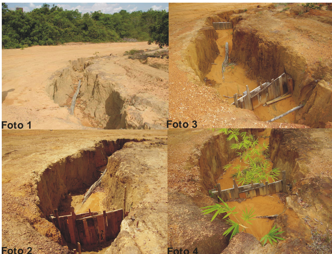
FIGURA 92 – Seqüência evolutiva da voçoroca nº 9 antes e depois da aplicação da contenção. Foto 1 - cabeceira antes da contenção em novembro/2005. Foto 2 - cabeceira logo após da introdução da barragem de contenção em agosto/2006. Foto 3 - maior quantidade de sedimentos e brotação dos bambus em dezembro/2006. Foto 4 - grande acúmulo de sedimentos e bambus com mais de 0,5 m em julho/2007. A madeira utilizada nas barragens constitui-se de restos ( pallets – estrutura de madeira utilizada para o transporte de mercadoria) descartados por algumas empresas do Distrito Industrial. 1º BIS (Amv). Bairro São Jorge. Manaus-AM.
