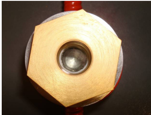
Figura 22 – Vista superior do visor de fluido instalado na entrada da seção de testes
