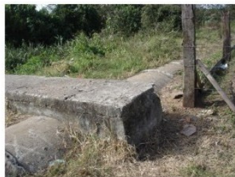
Duto de canalização acima da superfície localizado no final da rua.
