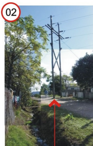
Poste da Rede de Alta Tensão
