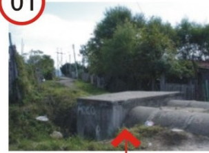
Duto de canalização
