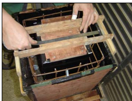
Ajuste e fixação da forma da parte interna do cálice para concretagem do restante do bloco.
