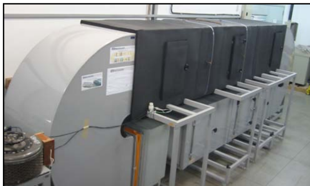
Figura 38: Detalhe do isolamento de borracha elastomérica
