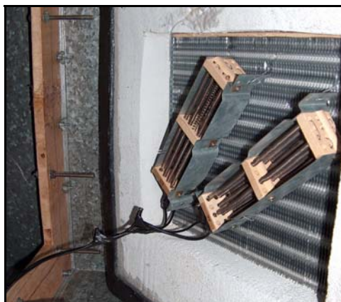
Figura 59: Resistências elétricas montadas sobre o condensador
