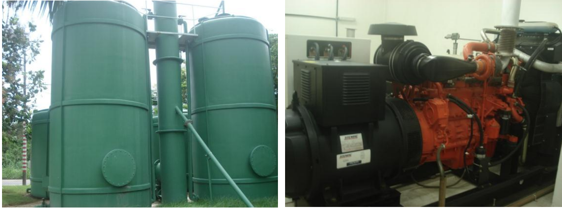
Figura 18: Torre de resfriamento de água e Gerador de energia Hotéis 4 e 1
