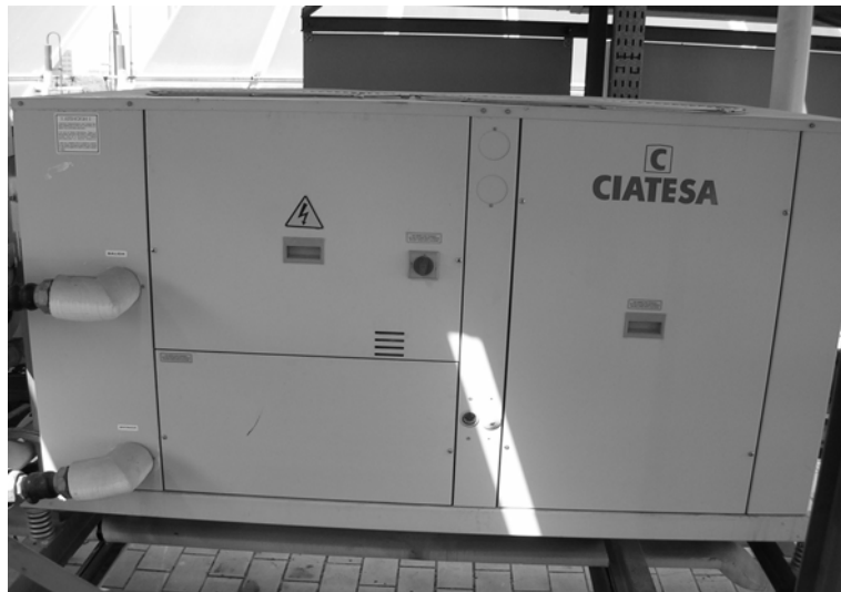
Figura 5.22 – Bomba de Calor.
