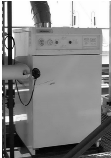
Figura 5.20 – Caldeira de Gás.
