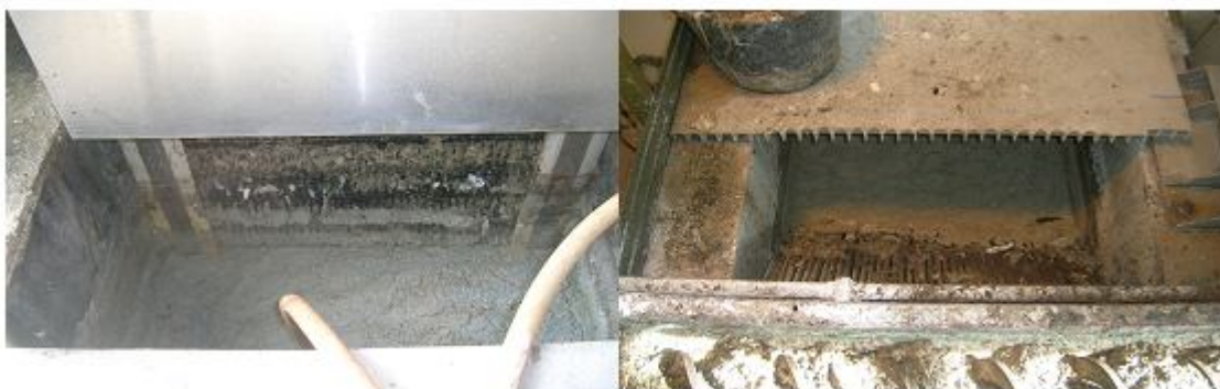
Figura A3.5 – Escumas na obra de entrada.
