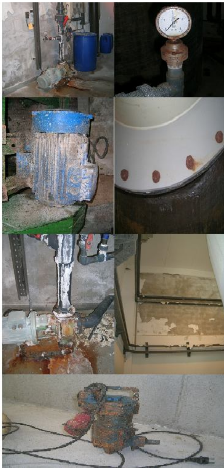
Figura A3.2 – Corrosão imposta especialmente devido ao H_2S .
