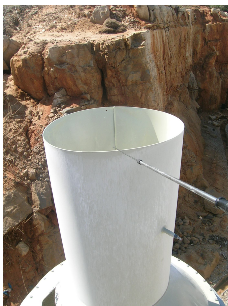
Figura A3.1 - Saída da Torre Alcalina, fim do tratamento odorífico (exceção aos pontos de amostragem).
