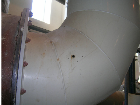
Figura 4.6 - Orifício na tubagem de ventilação
