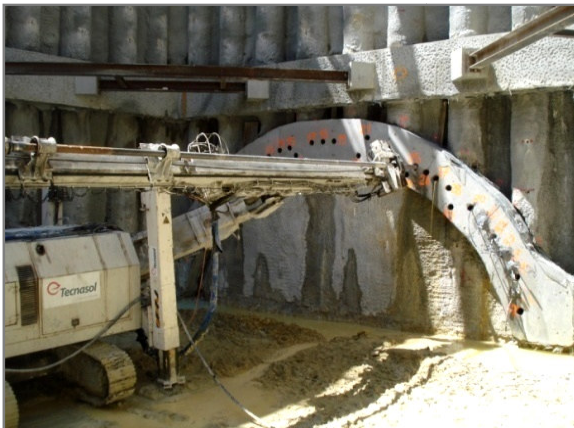
Figura 7.33 – Execução da furação para a realização das enfilagens (fotografia cortesia Eng.º André Carmo).
