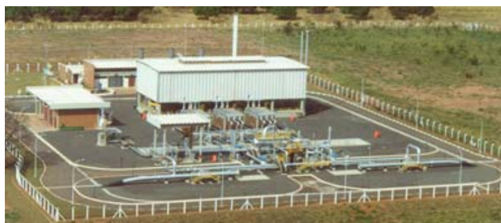
Figura 1.3: Vista geral de uma estação de compressão (cortesia da empresa-alvo).
