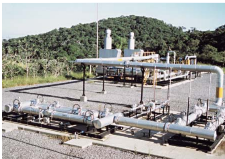
Figura 1.2: Estação de entrega (cortesia da empresa-alvo).
