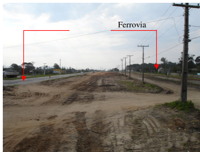
Figura 127 – Obras de duplicação da BR 101 ao lado do leito da ferrovia. Fonte: Acervo Rodrigo Althoff Medeiros.
