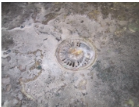
Figura 14: Efluentes Perigosos na Rede de Esgotos
