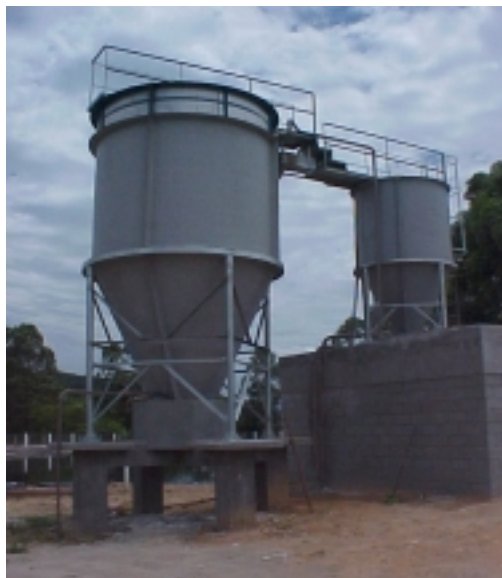
Figura 27. Sistema de tratamento físico de efluentes do aterro sanitário.
