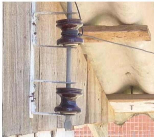
Figura 2.11 – Isolador elétrico em serviço
