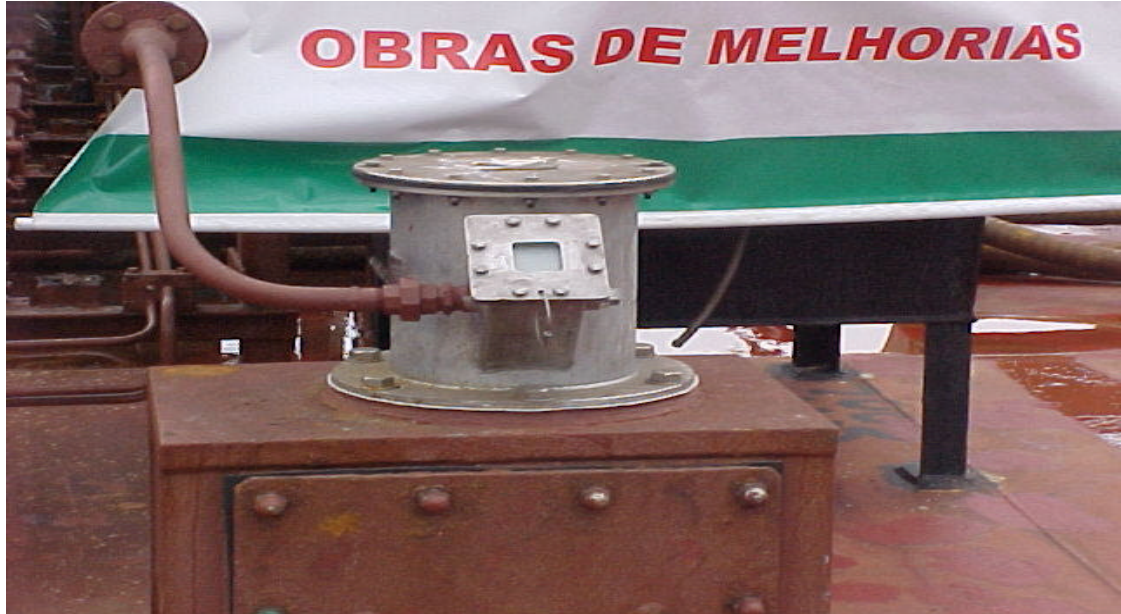
Fig.4.7 – Sonda radar de tanque de carga instalada no convés principal.
