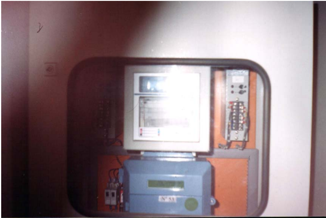
FIGURA 09 – MEDIDOR, REGISTRADOR DA VAZÃO DE ESGOTO BRUTO.
