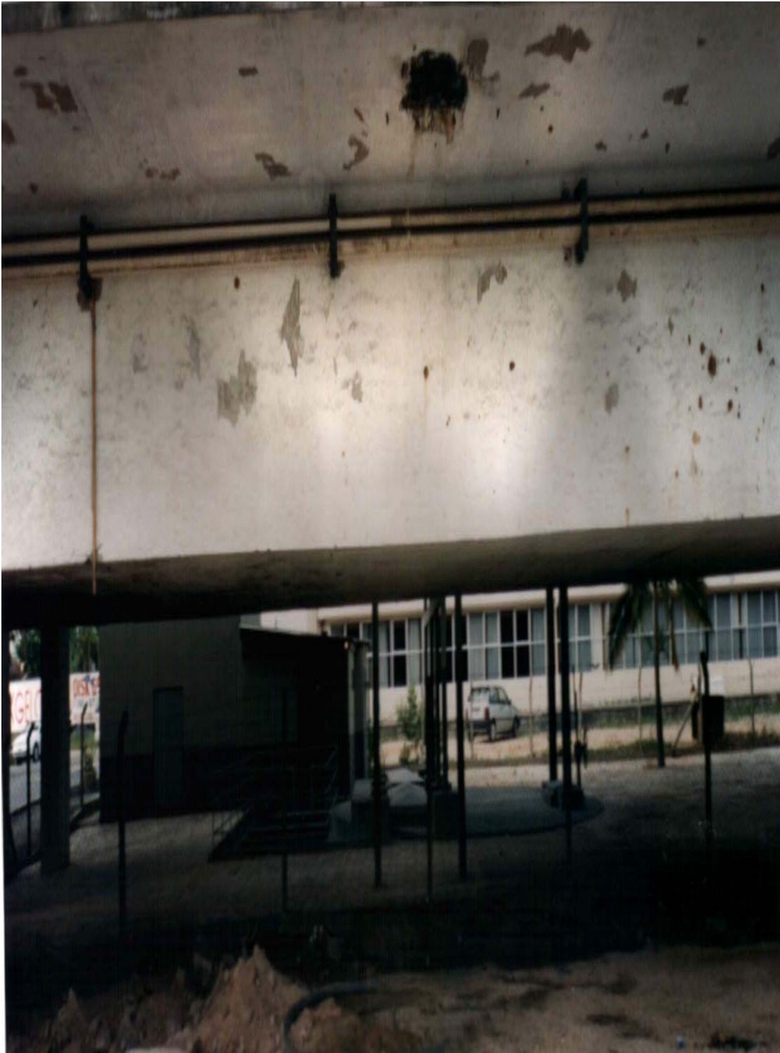
FIGURA 08. ESTAÇÃO DE RECALQUE 1 (ER-1).
