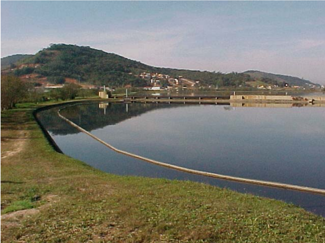
FIGURA 40 – CANAL DE DISTRIBUIÇÃO DOS ESGOTOS NA (LA-1) E CANAL CONDUTOR DOS EFLUENTES PARA A CAIXA EXTRAVAZORA QUE ALIMENTA EM SÉRIE A (LF-1) DO S.T.E QUE ATENDE PARTE DOS MUNICIPIOS DE FLORIANÓPOLIS (CONTINENTAL) E SÃO JOSÉ, SITUADO NO ÚLTIMO E É DENOMINADO FORQUILHINHAS.
