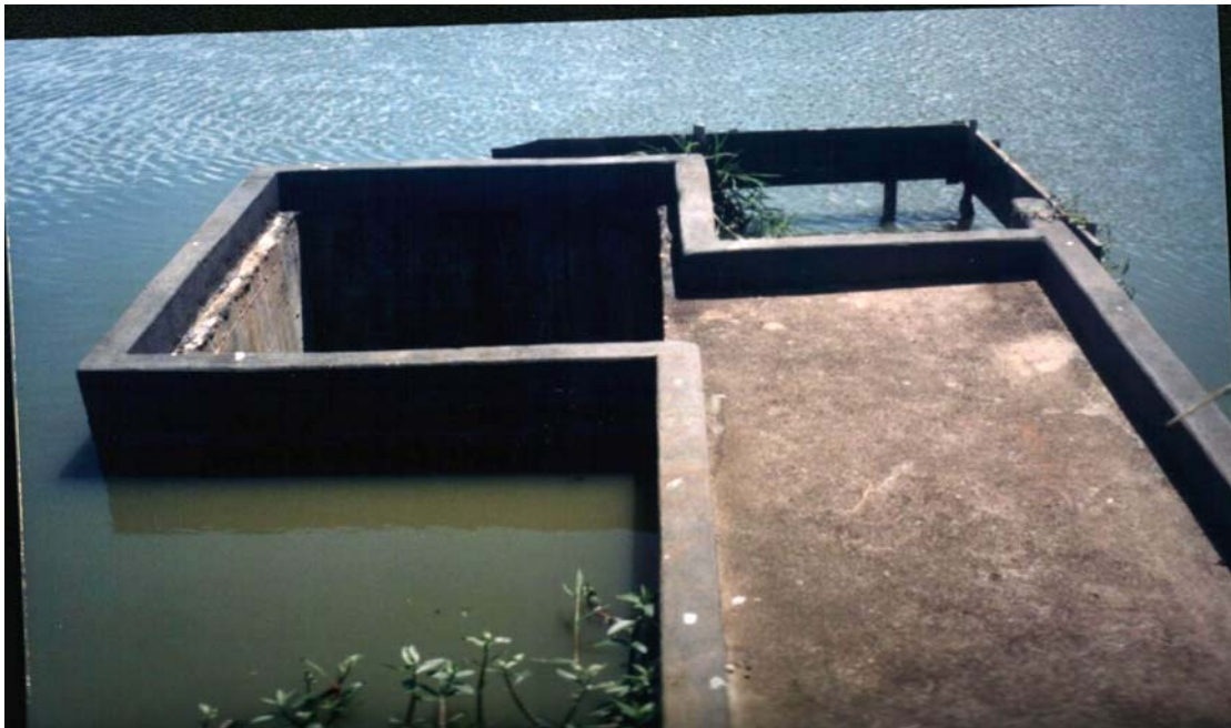
FIGURA 26 – (LF-2), (CE-7) E PASSARELA DE ACESSO A MESMA E A CAIXA DO (R-7).
