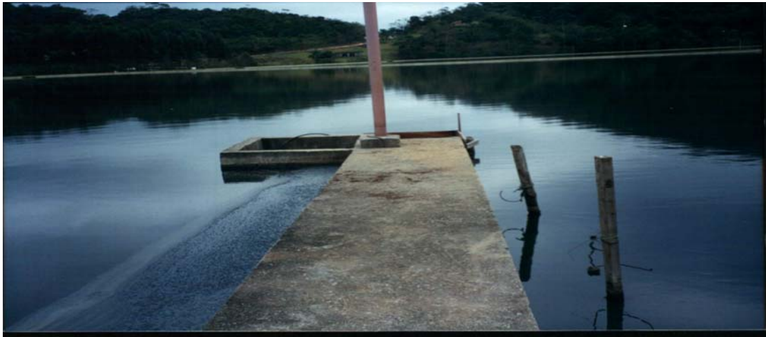
FIGURA 15 – LAGOA ANAERÓBIA 2 (LA-2) PASSARELA DE ACESSO A (CE-4) E A CAIXA DO (R-3), AO FUNDO A LAGOA ANERÓBIA 1 (LA-1) E AS (CE-TQ2, CE-TQ3 E CE-TQ4).
