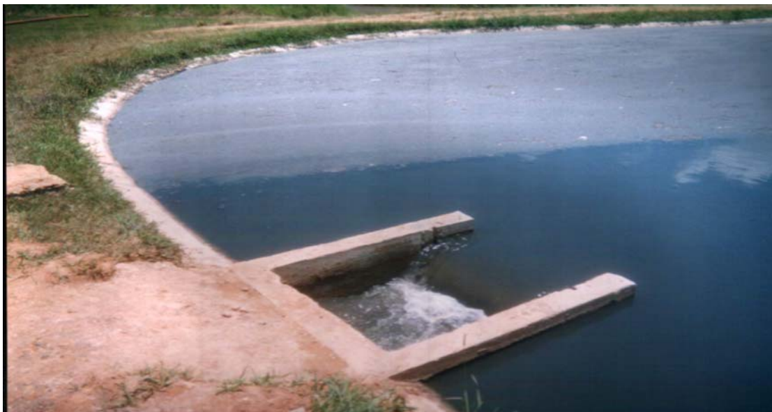
FIGURA 16 – LAGOA ANAERÓBIA 2 (LA-2): CAIXA EXTRAVASORA PARA TRATAMENTO QUÍMICO 5 (CE-TQ5).
