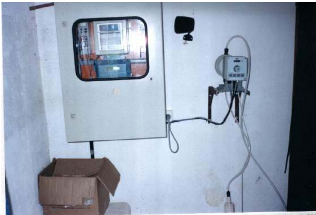
FIGURA 4: MEDIDOR DE VAZÃO DOS ESGOTOS DOMÉSTICOS E BOMBA DOSADORA DE NaOH UTILIZADA PARA ATENUAÇÃO DE ODORES DAS LAGOAS ANAERÓBIAS DO STE DA SEDE DO MUNICÍPIO DE JOINVILLE, SC, (10/12/1999).
