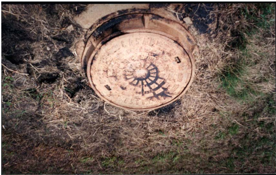
FIGURA 27 – (PV-1) RECEBE OS EFLUENTES DA (LF-2).
