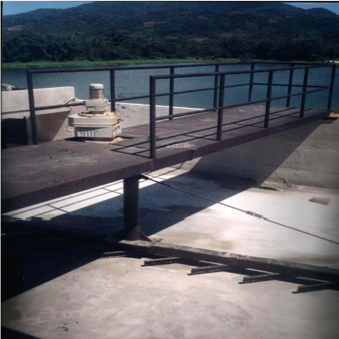
FIGURA 39 – TRATAMENTO PRELIMINAR: CAIXA DE AREIA ELETROMECHANIZADA.
