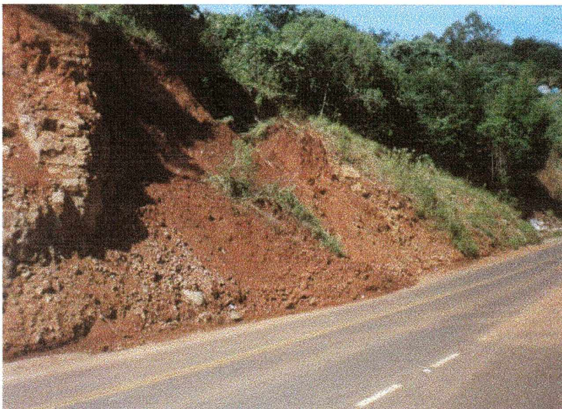
FIGURA 4.9 – Escorregamento em corte (SC-454)
