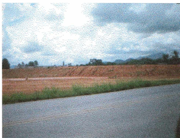
FIGURA 7.11 – Erosão em sulco
