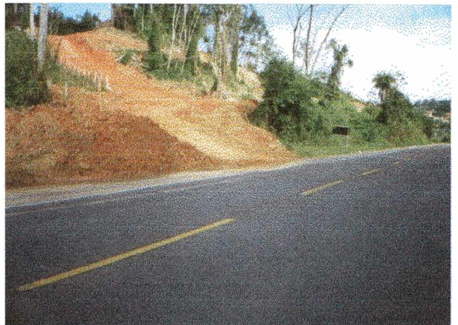
FIGURA 7.16 – Ausência no controle do uso do solo
