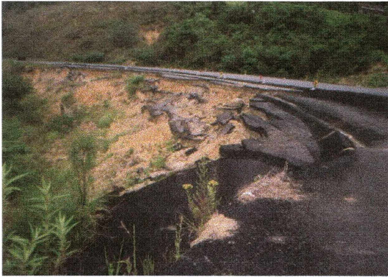
FIGURA 4.10 – Escorregamento em aterro (BR-282/SC)
