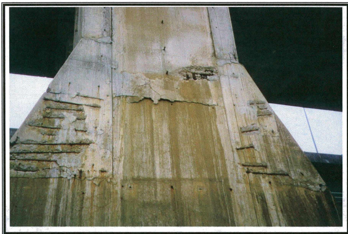
Figura 3.4 – Estado de deterioração localizada do apoio 10
