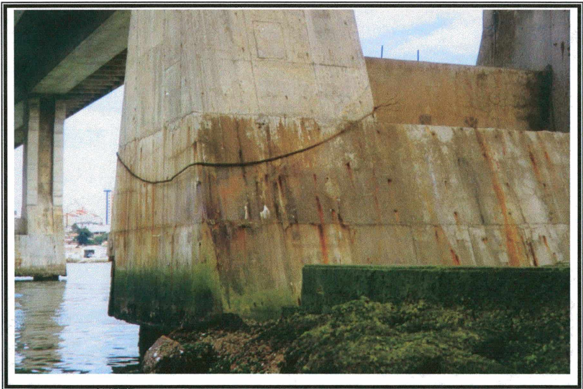
Figura 3.5 – Estado superficial do bloco de coroamento do apoio 10.
