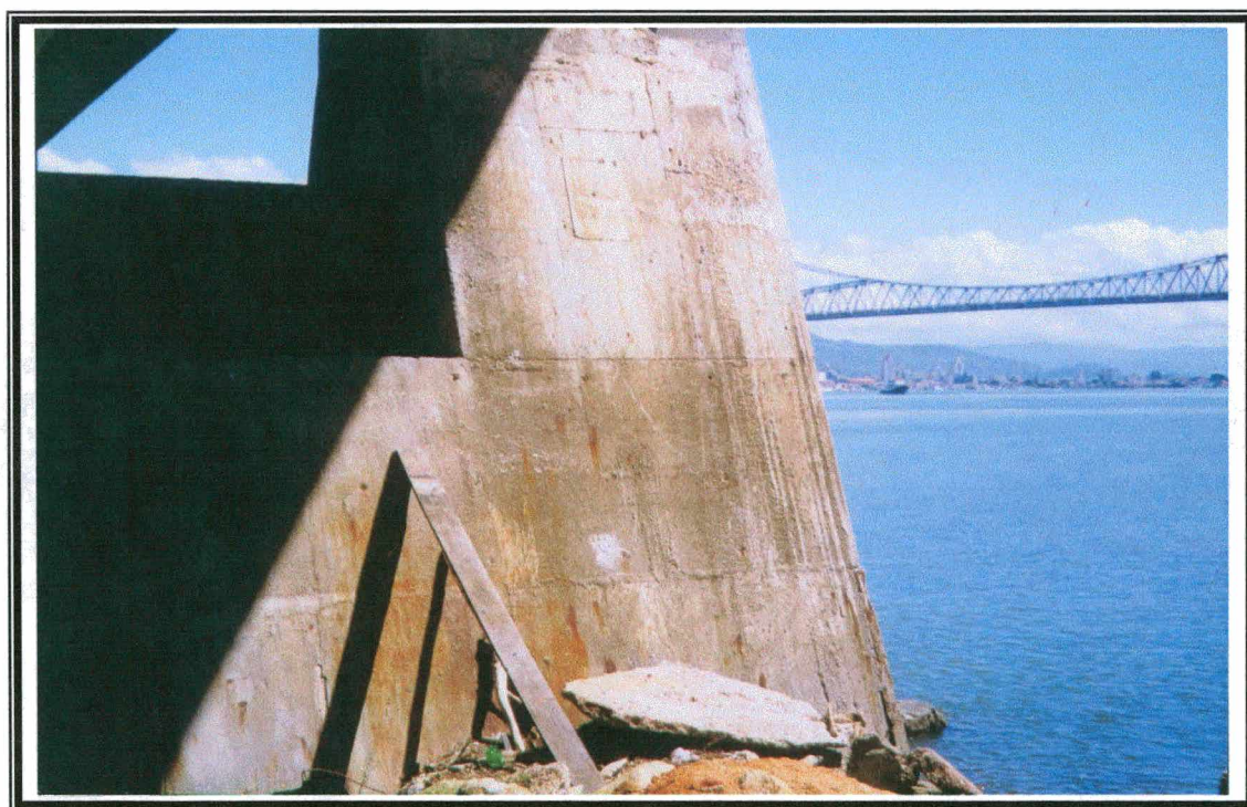
Figura 3.10 – Insolação diferenciada no pilar norte, face norte - apoio 10.
