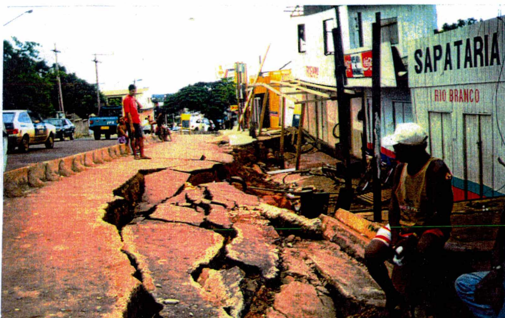
FOTO 6 - Área comercial na Rua Floriano Peixoto - bairro da Base - também afetado por movimentos de massa - É possível observar a formação de pequenos degraus no início do processo de deslocamento - Fev/96
