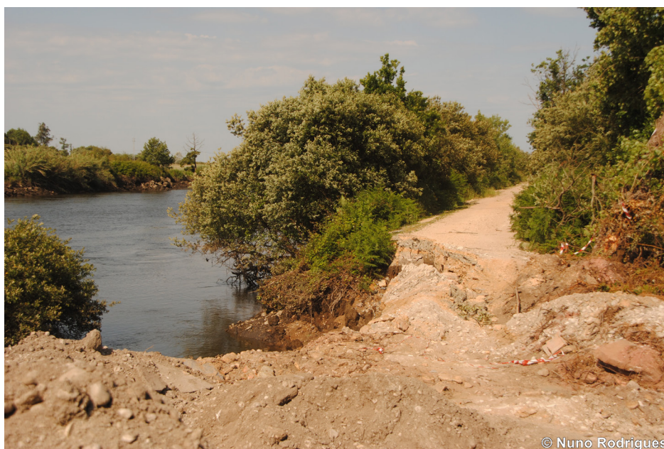
Figura 4. Colapso das margens do rio Vouga, em Cacia, em maio de 2014.
