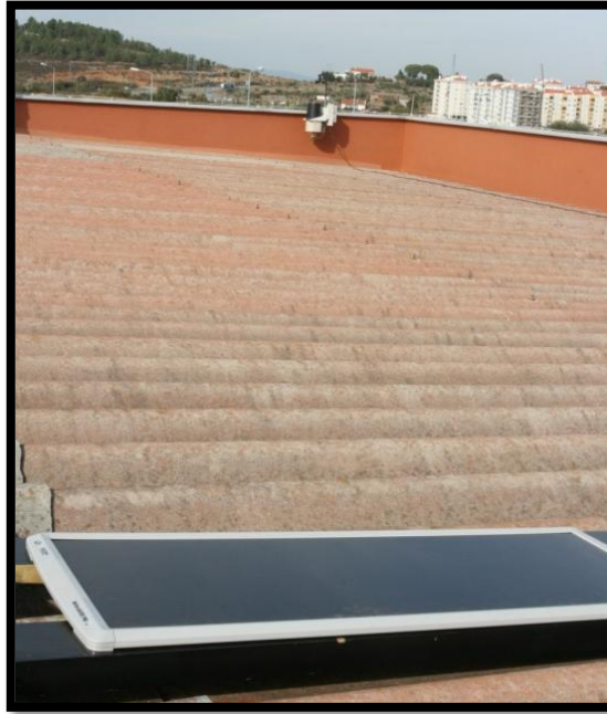
Figura 31 - Painel Solar e Estação (ao fundo)
