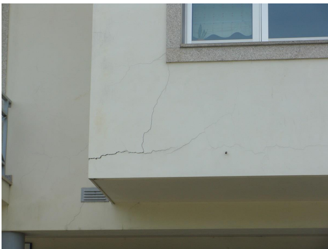
Fig. 4.9 – Caso real fissuração de paredes de alvenaria devido à deformação da laje em consola
