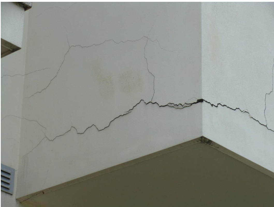
Fig. 4.11 – Caso real fissuração de paredes de alvenaria devido à deformação da laje em consola
