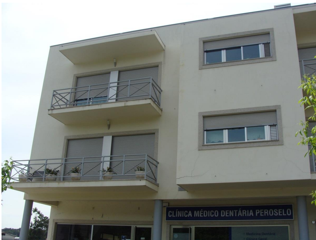
Fig. 4.8 – Caso real fissuração de paredes de alvenaria devido à deformação da laje em consola
