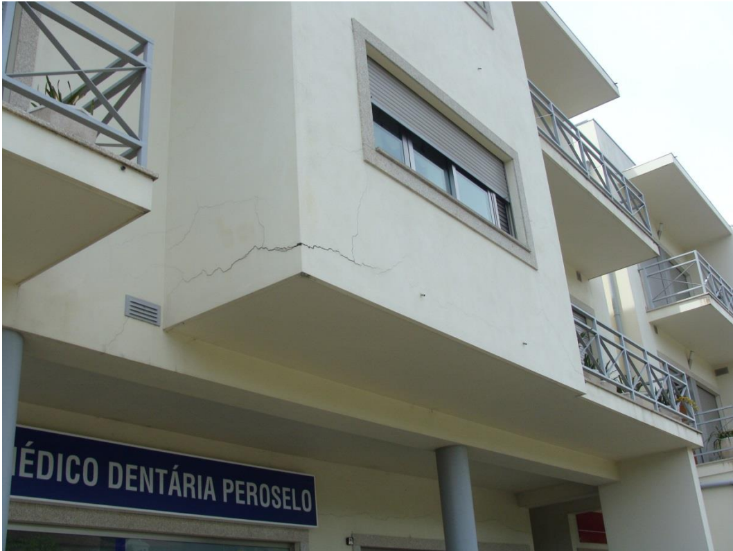
Fig. 4.10 – Caso real fissuração de paredes de alvenaria devido à deformação da laje em consola
