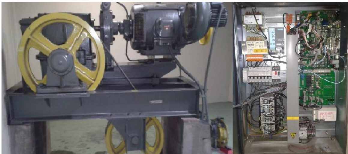
Figura 6.38 – Esquerda: Grupo elevador, Direita: Quadro do elevador.
