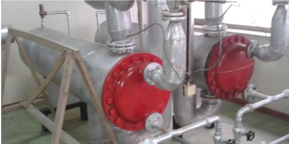
Figura 6.15 – Permutadores situados na subestação 3.
