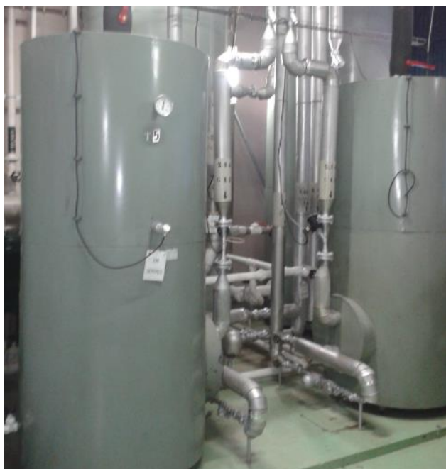
Figura 6.16 – Vista geral dos Termoacumuladores.
