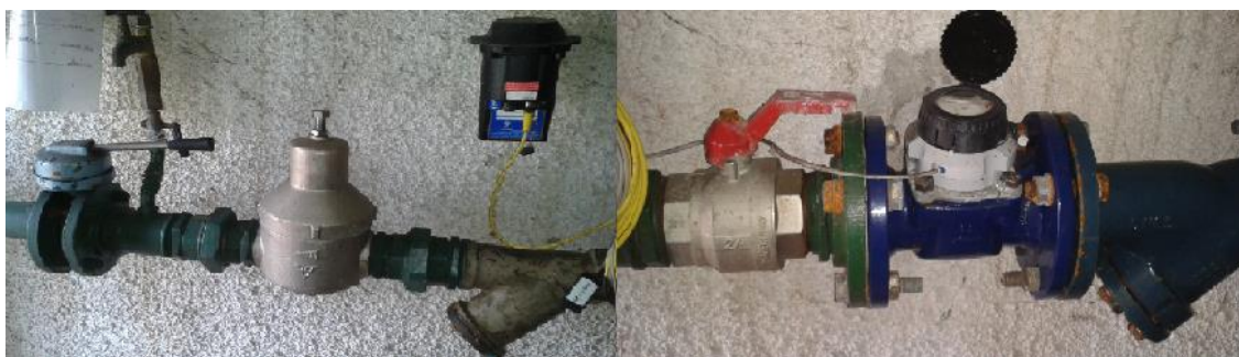
Figura 6.17 - Contador da água e aparelhos de segurança.
