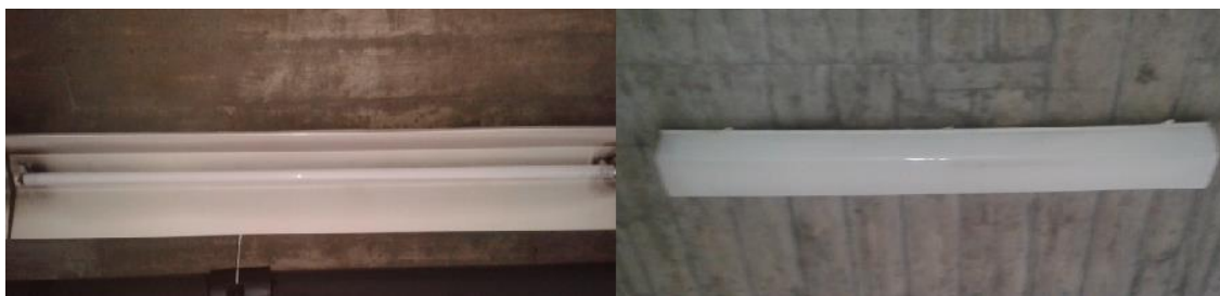
Figura 6.26 - Armaduras para lâmpadas fluorescentes (Esquerda: luminárias industriais, Direita: Luminárias salientes e suspensas).
