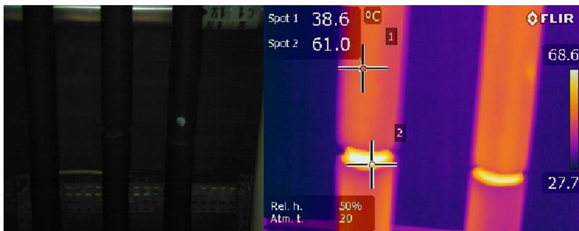
Figura 6.34 – Esquerda: Registo digital, Direita: Registo térmico, de uma falha de isolamento.
