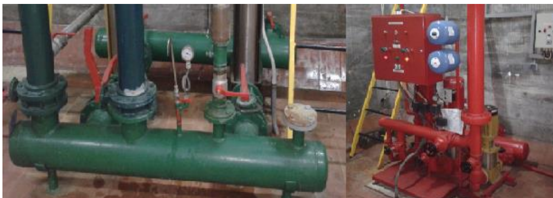
Figura 6.18 - Bomba elevatória e bomba central supressora.
