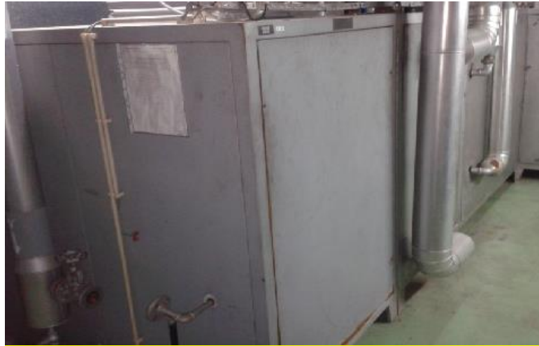
Figura 6.14 - Unidade de tratamento de ar.
