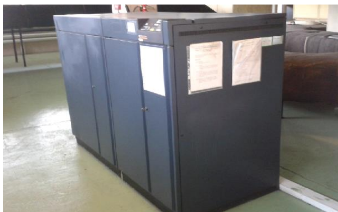
Figura 6.7 – Fonte de alimentação ininterrupta do bloco operatório.
