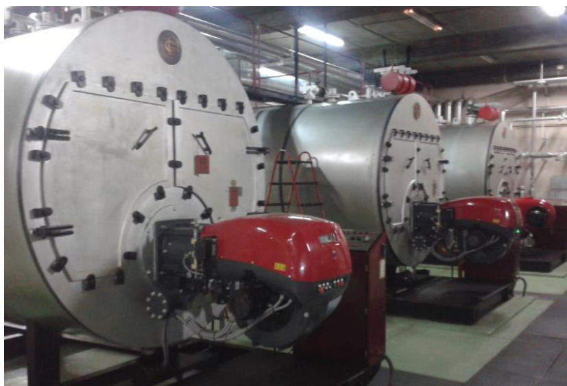
Figura 6.11 – Caldeiras da unidade hospitalar (Esquerda: duas caldeiras a gás natural, Direita: caldeira a gasóleo).
