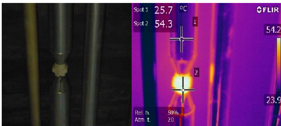
Figura 6.35 – Esquerda: Registo digital, Direita: Registo termográfico, de falha de isolamento.
