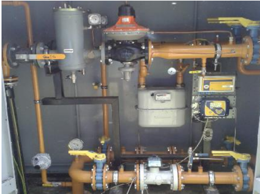
Figura 6.9 - Contador de gás e respetivos aparelhos de controlo e segurança.
