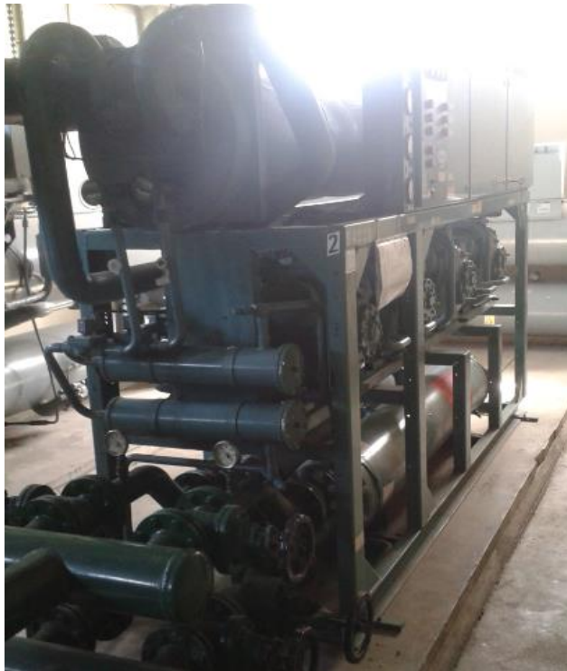
Figura 6.12 – Chiller que produz água refrigerada para as salas do bloco operatório.
