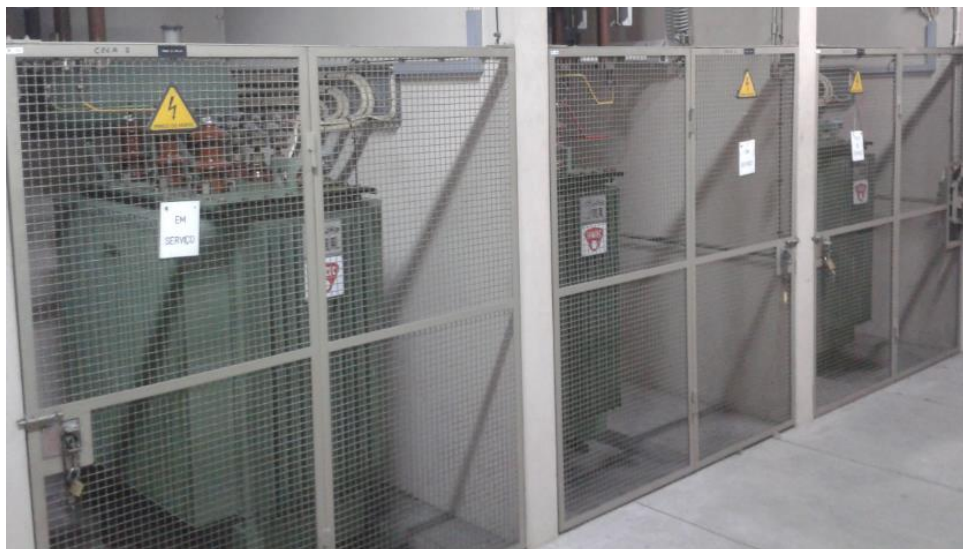
Figura 6.5 –Vista interior do posto de transformação – transformadores de potência.
