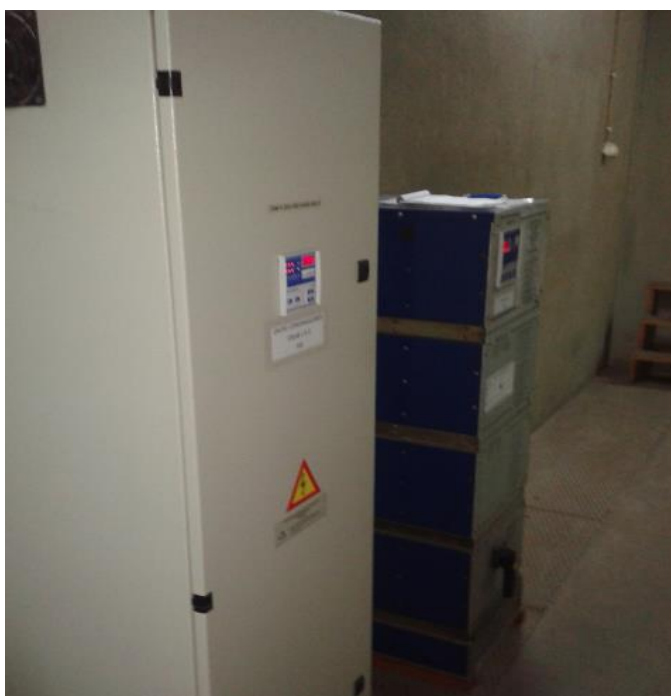
Figura 6.28 - Baterias de condensadores.
