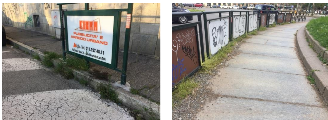
Figura 8. Le transenne di sicurezza possono interferire con le operazioni di pulizia, favorendo l'insediamento della vegetazione infestante (a sinistra: Grugliasco, TO, 45.0687° N, 7.5889° E; a destra: Torino, 45.0744° N, 7.6897° E. Foto F. Vidotto).
