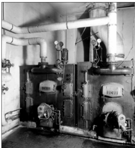
Fiat, cucina. Centrale termica (Archivio storico Fiat, Torino – Fondo Ugaf 34, Cucina Aziendale, p. 7)
