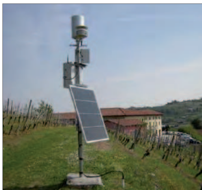
Figura 1: Stazione master installata a Alba
