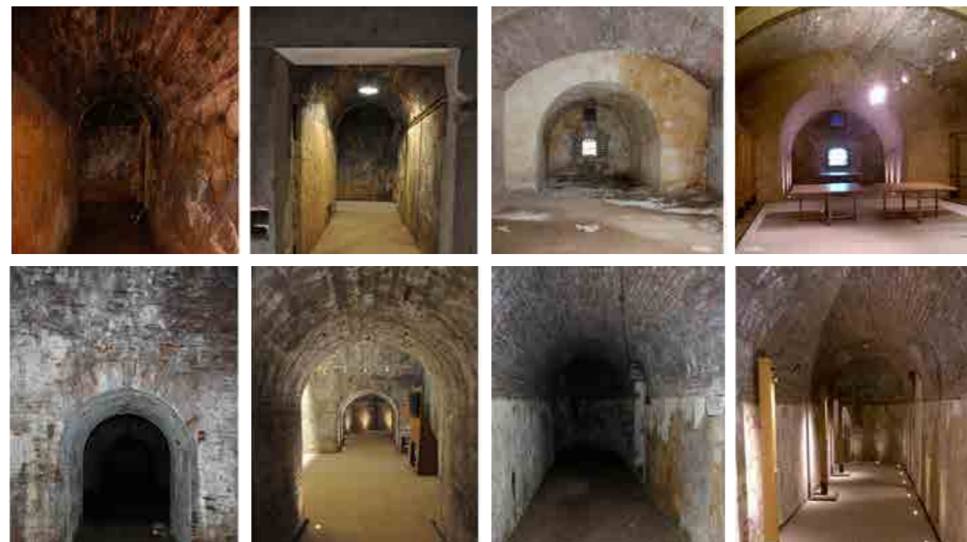
Fig. 164 (sotto) una serie di vedute prima e dopo il restauro delle sale interne del bastione delle Maddalene a Verona. Fig. 165 (a fianco) la situazione esterna del bastione delle Maddalene ad opera in corso e a lavori ultimati nella fotografia in basso.
