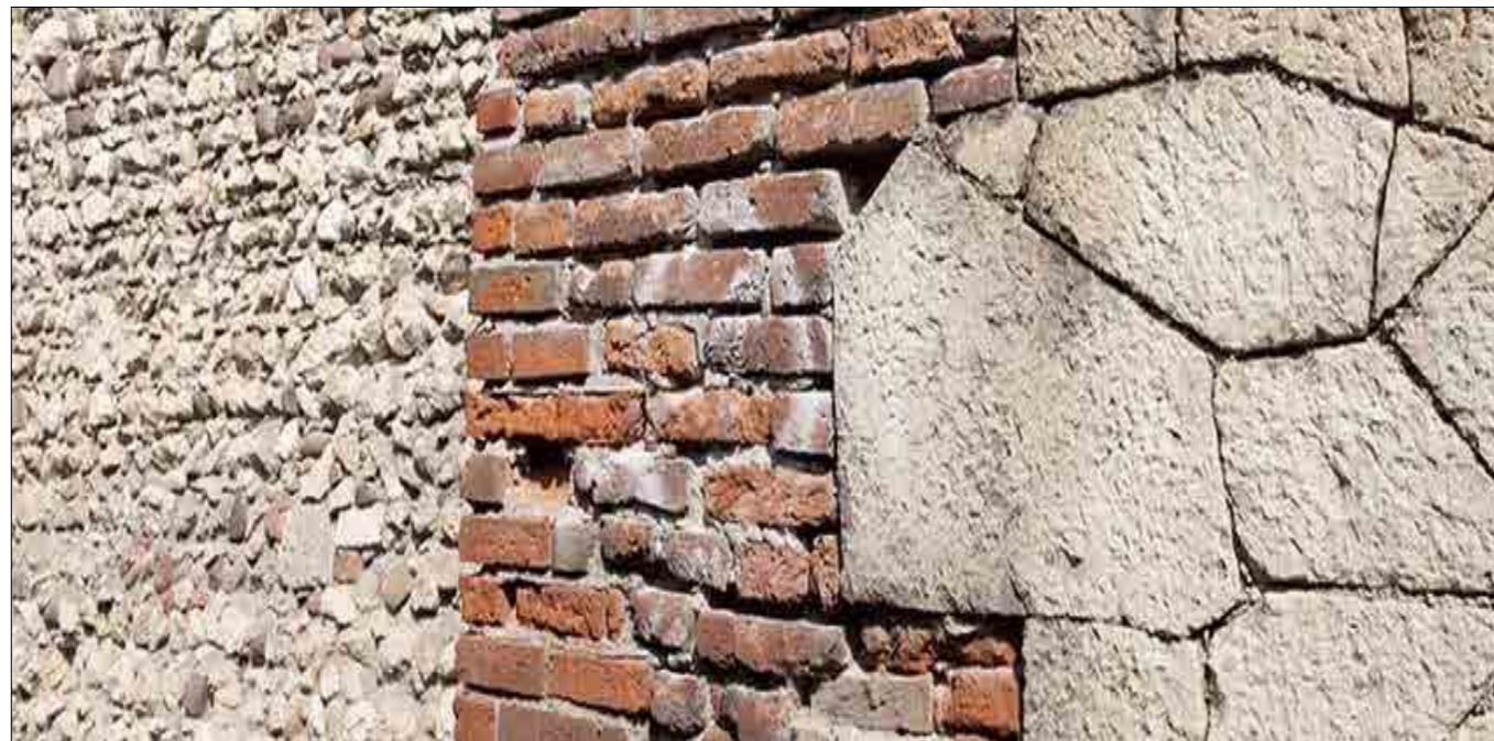
Fig. 30 Dettaglio del paramento murario nel quale si evidenziano diverse soluzioni costruttive: partendo da sinistra tratto di mura scaligere, veneziane e quindi le poligonali austriache
