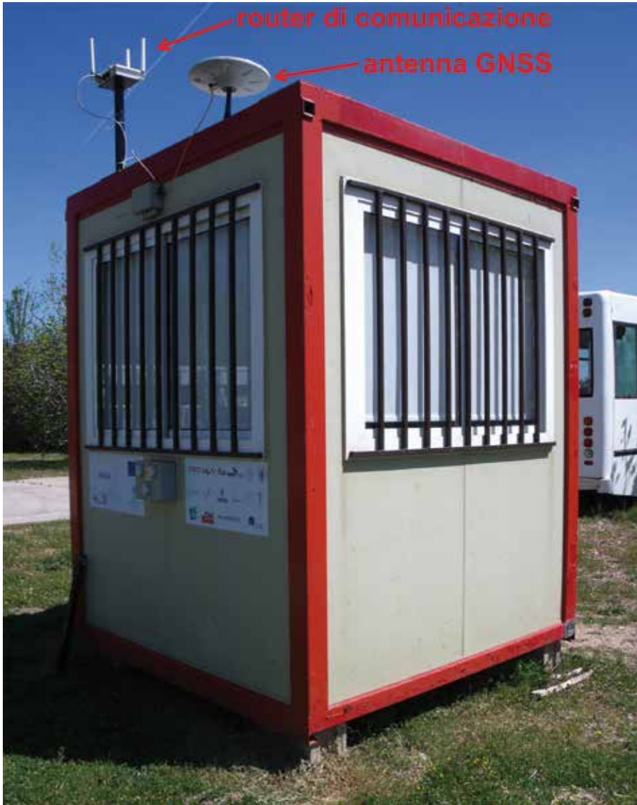
Fig. 2.8 Cabina della base station con router di comunicazione e antenna GNSS installate sul tetto.
