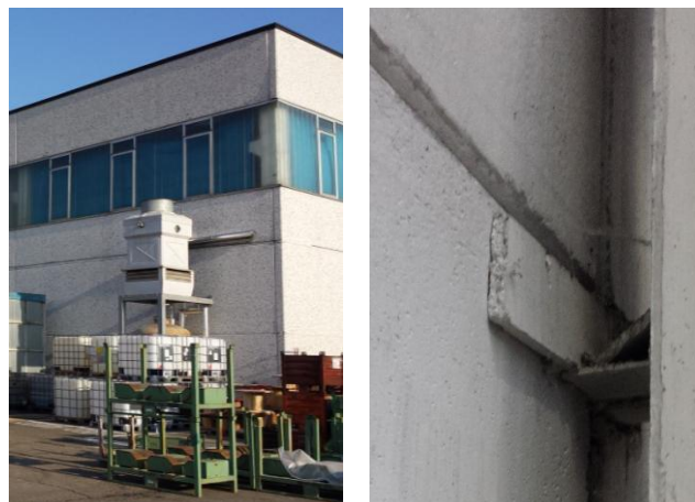
Figura 7. Particolare pannelli orizzontali esterni lotti 1, 2 e 3 e sistema di connessione (visto dall'interno).
