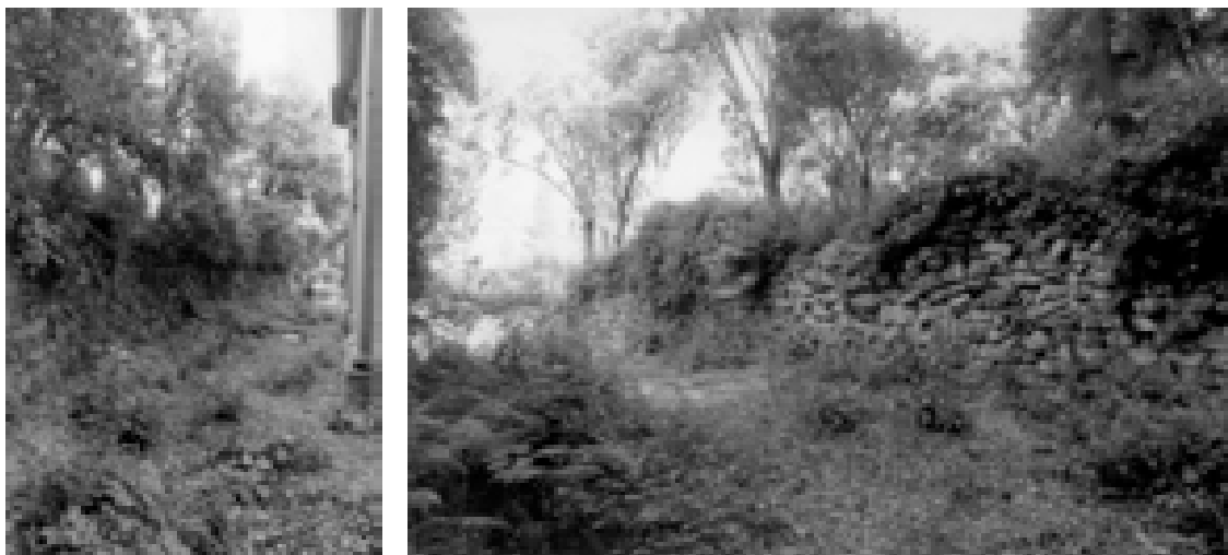
Figura 324 – Muri a secco di sostegno del terrapieno retrostante la Limonaia – anni '70-'80 (AABS)
