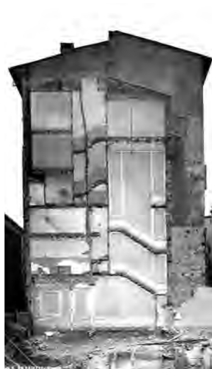
3 I resti del fabbricato demolito su via Lamarmora
